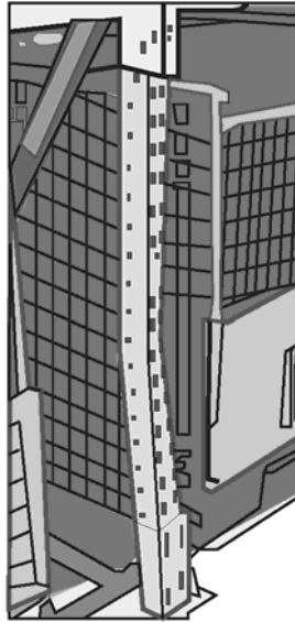
Figura D.2 – Daños de un puntal a 1000 mm aproximadamente por encima del nivel del suelo de un módulo en el que se produjo un gran derrumbe
